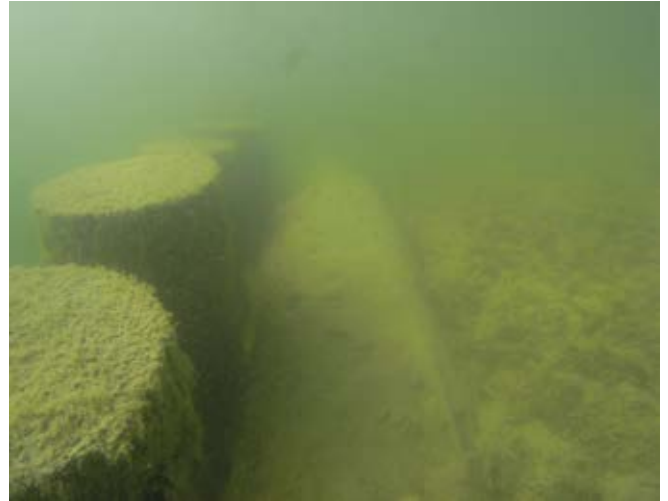
Abb. 8 - Risch Buonas ZG. Bündiger Abschluss der Geotextilwalze am oberen Ende der Abbruchkante, Lücken haben sich geschlossen. Foto P. Schwörer, Amt für Städtebau, Zürich.
