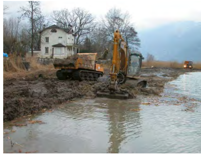
Fig. 11 - Aix-les-Bains, baie de Mémard (Savoie, lac du Bourget). Malgré la proximité de plusieurs sites immergés, les travaux de revitalisation des roseières menés sur près de 10000 m 2 n'ont pas donné lieu à un diagnostic préalable. Cliché AM/Drassm.
