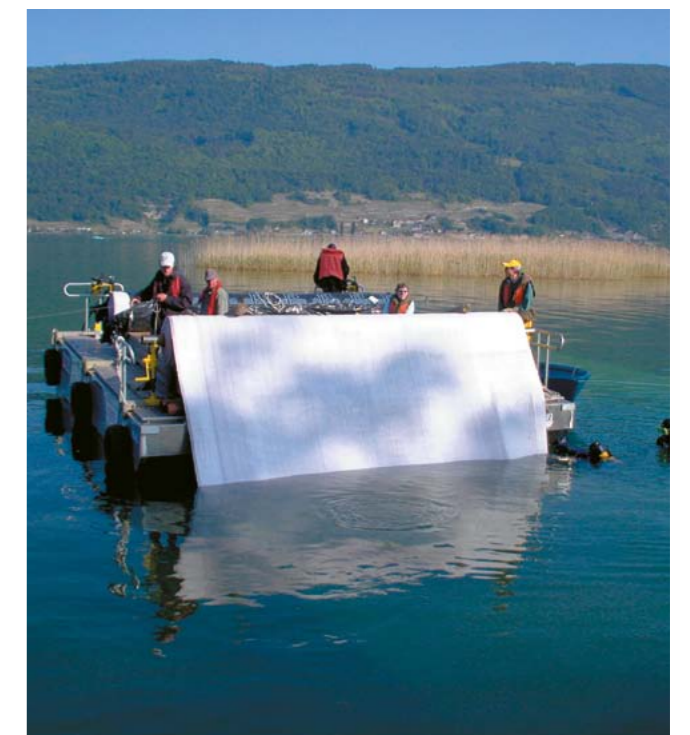
Fig. 3 - Sutz-Lattrigen – Hauptstation. Mesures de protection contre l'érosion 2003-2004. Les tapis en géotextile, lourds d'environ 1 tonne, ont été posés grâce à un bateau spécial. La déposition d'une fine couche de gravier était également effectuée à partir de ce bateau. Tous les travaux étaient exécutés par l'équipe de plongée. Dans la baie de Lattrigen, 6 000 m 2 de surface archéologique ont été recouvertes et 30 000 m 2 ont été fouillés.
