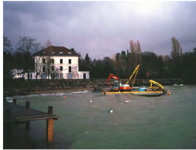
Fig. 9 - Chens-sur-Léman, Tougues (Haute-Savoie, lac Léman). Malgré le classement du gisement Bronze final au titre des Monuments Historiques, un engin est ancré dans le périmètre de la protection juridique. Cliché AM/Drassm.
